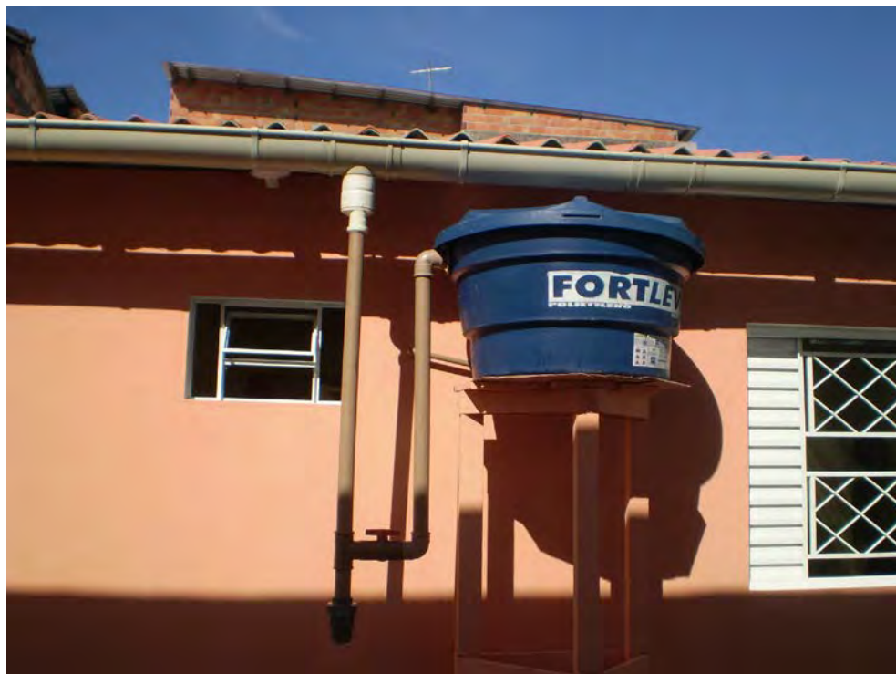
Foto 2 - Detalhes da captação das águas das chuvas. Todas as partes devem ser hermeticamente fechadas para evitar proliferação de fungos.
