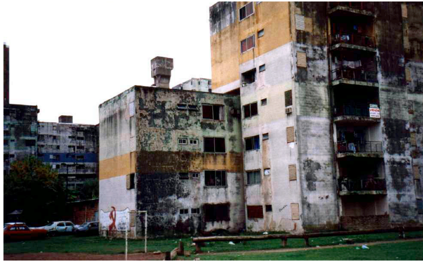
Figura 3: Conjunto Urbano Cmte. Piedrabuena (Plan Alborada, luego FONAVI, 1979) Buenos Aires. Foto de archivo del PMH, 1995.
